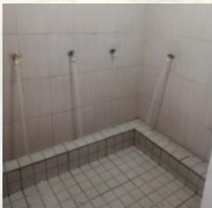
Gambar 47 Kran yang Terpasang aerator di Tempat Wudhu
