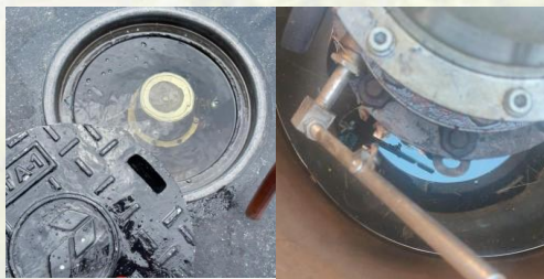
Gambar 35 Kondisi Hydrant Pit Kondisi Penuh Cairan
