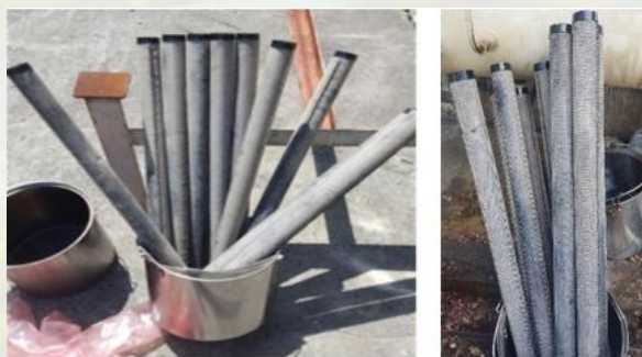
Gambar 27 Hasil Pengecekan Kondisi Element
