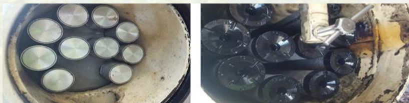
Gambar 26 Kondisi Inlet dan Outlet Filter Solar
