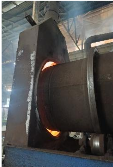
Gambar 1 Celah pada Unit Rotary Dryer
