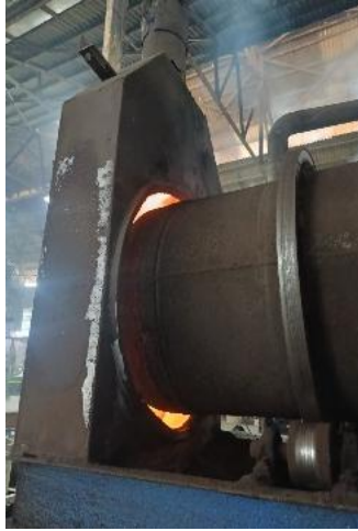
Gambar 1 Celah pada Unit Rotary Dryer
