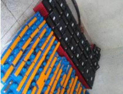
Dokumentasi Unit Baterai Kering
