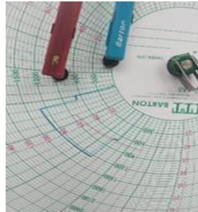
Hasil Pengujian Tekanan pada Pipa Baru
