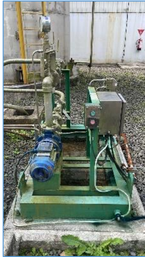
Gambar 2. 5 Backwash Pump Digunakan Sebagai Cleaning Sand Filter Ketika Differential Presseure Sand Filter Tinggi > 50 Mbar
