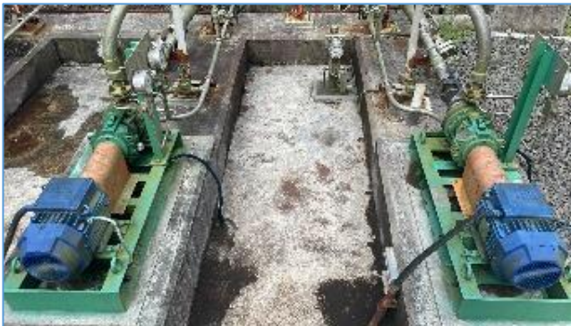
Gambar 2. 4 Raw Water Pump Untuk Supply Dari Water Reservoir Tank Ke Filterd Water Storage Tank Dengan Melewati Sand Filter
