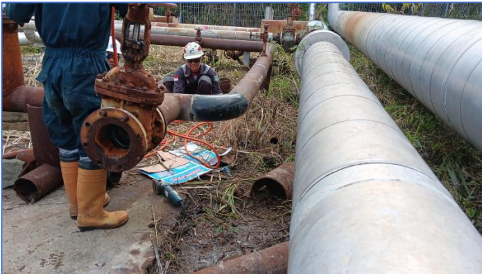
Gambar 1. 4 Fit Up pipa dan elbow 6 inci untuk di Instal lokasi jalur reinjeksi
