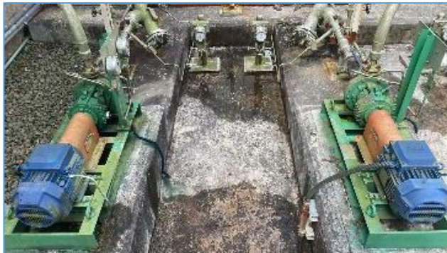
Gambar 2. 6 Potable Water Pump Supply ke Head Tank untuk nantinya menjadi keperluan domestic
