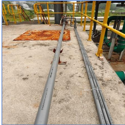
Gambar 4. 10 Jalur pipa untuk proses injeksi Biocicde N7330 ke Cooling Tower Basin
