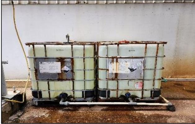
Gambar 3. 3 Tanki penampungan air condensat HVAC
