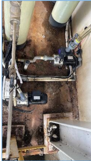
Gambar 2. 7 Pompa Transfer SDAH untuk mentransfer air ke condensat HVAC before Filter menuju penampungan After Filter SDAH dan mentransferkan air SDAH dari penampungan After Filter menuju Head Tank untuk dipakai sbg supply ke jalur CCW
