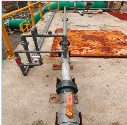
Gambar 4. 9 Ejector dari SIDOCTOR yang berfungsi untuk menarik bahan kimia Biocide N7330 dari tanki penampungan ke Cooling Tower Basin
