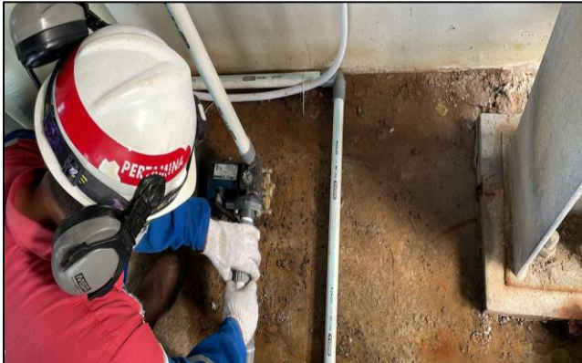
Gambar 3. 5 Instalasi pompa transfer dari tanki penampungan air demin ke tanki penampungan air domestic
