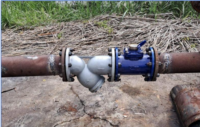
Gambar 1. 5 Instalasi Y Strainer dan Flowmeter sbg penunjang improvement Si-REKSI supaya laju alir air yang di reinjeksi ke sumur reinjeksi dapat termonitor dan sampah / benda asing dapat tersaring
