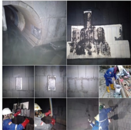
Gambar 2 Brick yang terlepas dari dinding wet scrubber smelter
