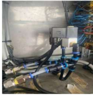
Kondisi tabung pneumatic setelah program
