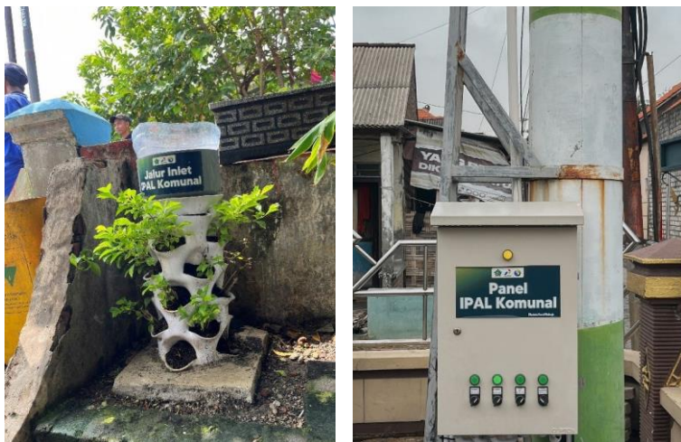
Jalur Inlet dan Panel IPAL Komunal
