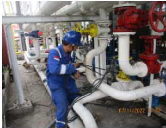
Gambar 42. Dokumentasi Main Pipe 6 Inch Sebelum Program
