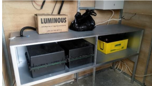
Gambar 2.7 Ruang Instalasi Solar Cell
